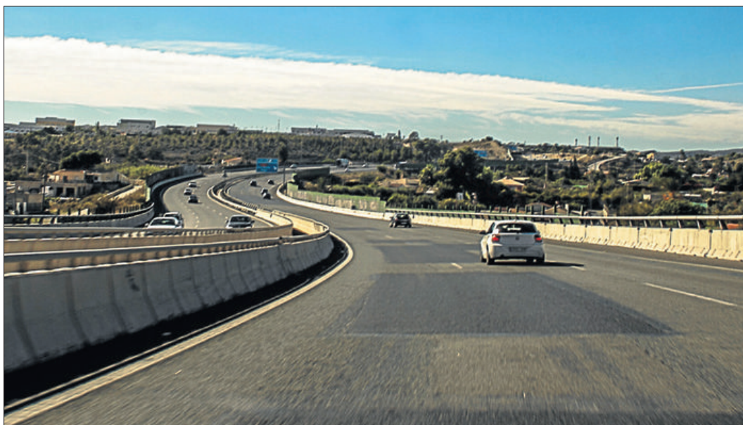
Vehículos circulando por el tramo de tres carriles de la A-7 en Elche que se encuentra en muy mal estado, este fin de semana. SERGIO FERRÁNDEZ
