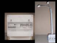
35-Cuadro electrico suelo
